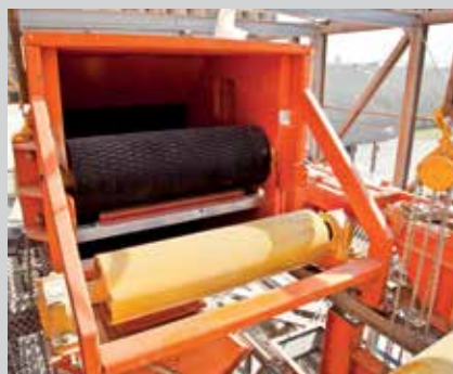
CORREIA TRANSPORTADORA 1.500 t/h (54")
